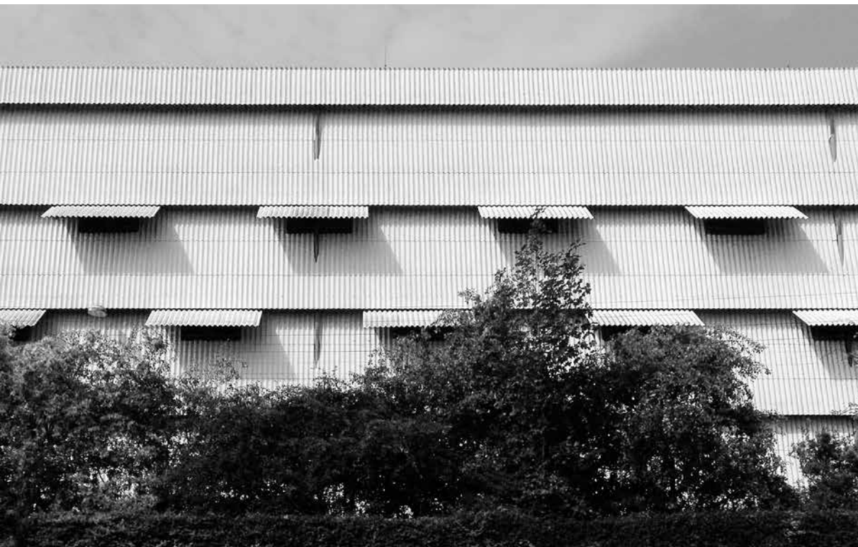
Sous-station Amager (1963/64) dotée de plaques de fibres-ciment en position relevée destinées à protéger les ouvertures.
