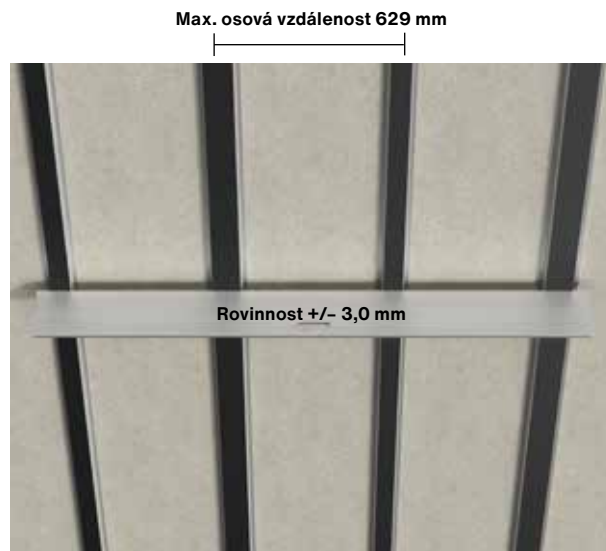
Rovinnost podkladní konstrukce
